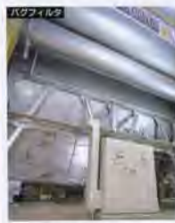
焼却炉の排気ガスは、バグフィルタによって、塵埃はほとんど取り除かれます。
