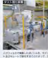
バグフィルタで吸着したダストは、セメントダストがベルトで運送する仕組みによって、正しい位置に回収されます。
