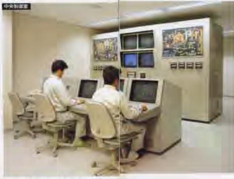
焼却炉の運転、ごみクレーン操作、公害防止装置の監視制御など、すべての運転操作・管理がこの一室で行われます。
